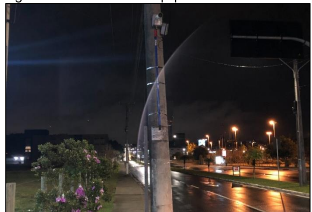
Figura 11: CPM-P002 – Equipamento Instalado.
